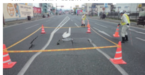
■ 平成28年4月熊本地震被害の状況
