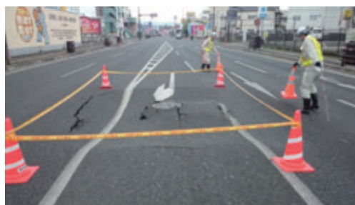
■ 平成28年4月熊本地震被害の状況
