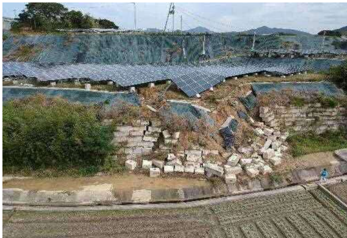
法面の崩壊が発生し、法面保護工が崩れて流出した事例
