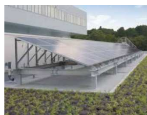
太陽光発電設備
