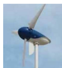
風力発電設備
