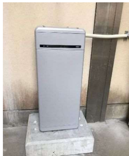
《蓄電池（※太陽光発電から充電）》
